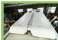
屋根上ユニット (凝縮器と蒸発器)
